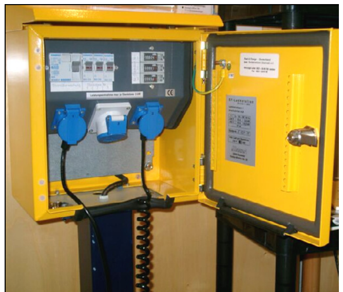
Typische Park & Charge Station, dreiphasig, 2 x Schuko und 1 x CEE Steckdose, mit FI-Schalter, 3x 16A Sicherungen und kWh-Zählern
